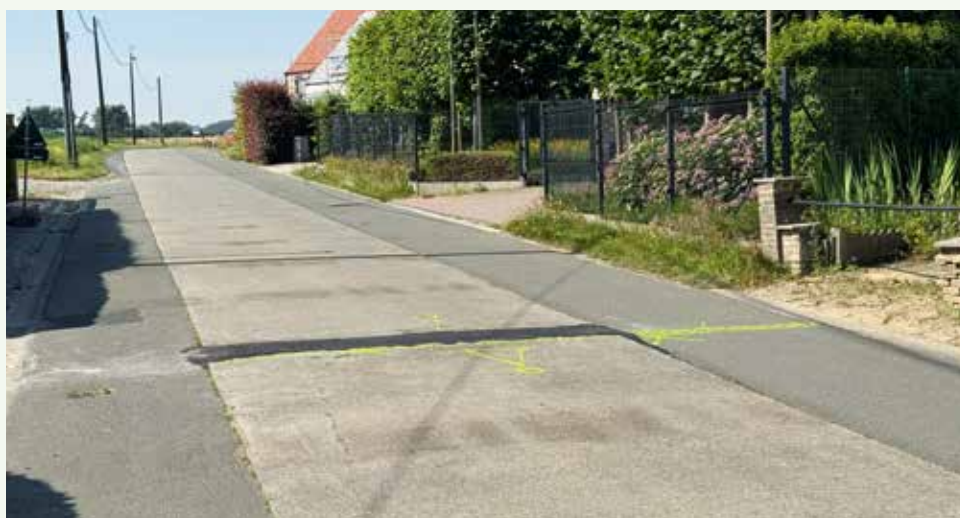
Herstel van het door de hitte vervormde wegdek op verschillende locaties
